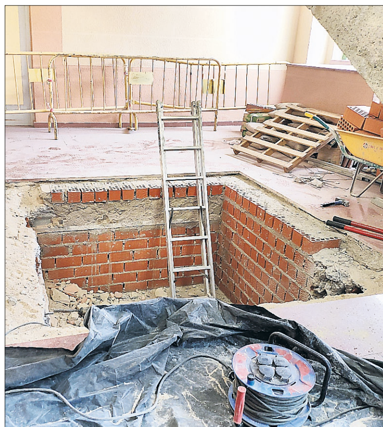
Obras en el pabellón Pedro Delgado para la instalación de un ascensor. / IMD SG
