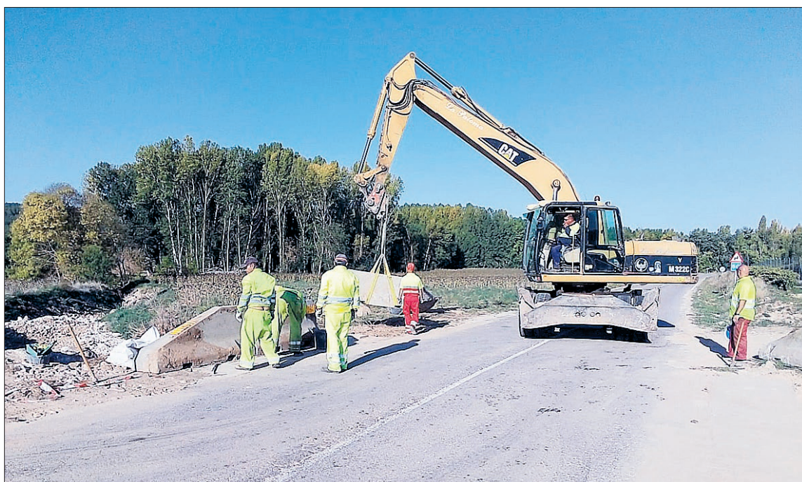
La carretera entre Cobos de Fuentidueña y Carrascal presentaba numerosos daños. / EL ADELANTADO
