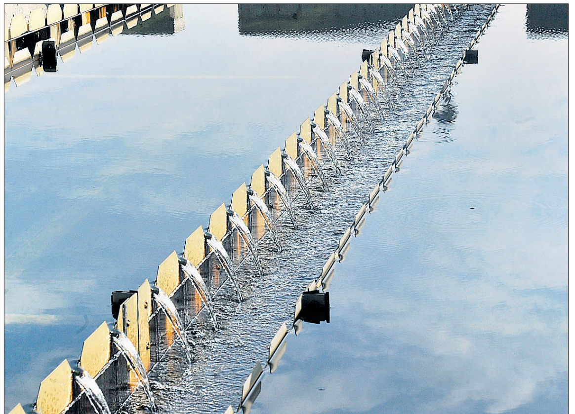
Estación de Tratamiento de Agua Potable (ETAP) del Rancho del Feo. / KAMARERO
