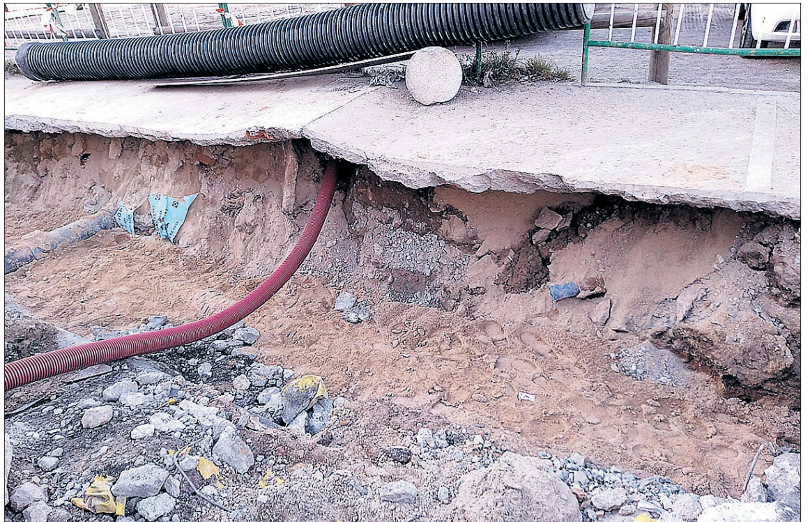
Imagen de las oquedades descubiertas en el transcurso de los trabajos. / EL ADELANTADO
