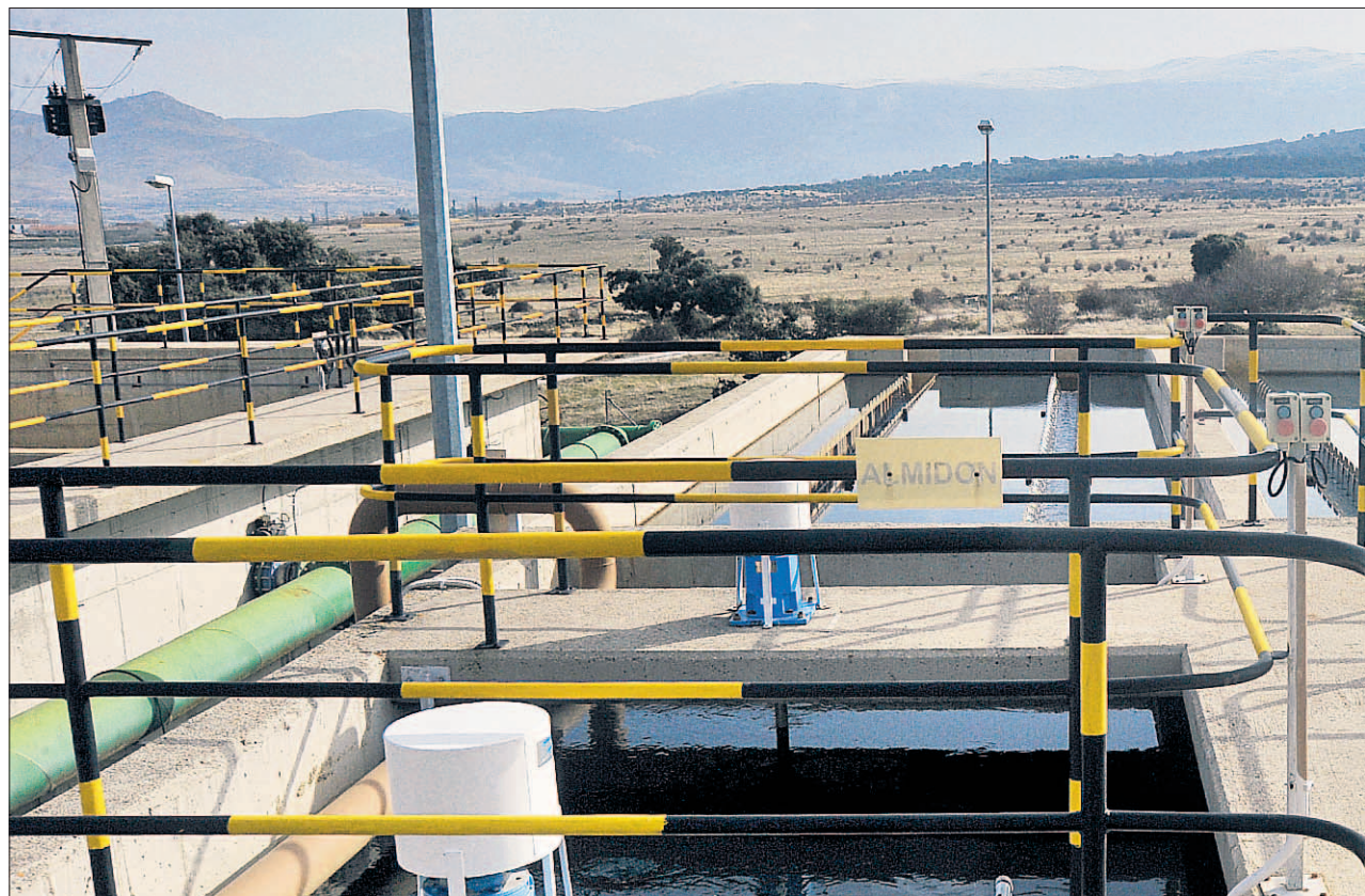
Desde la ETAP Rancho el Feo se abastece de agua a la zona alta de la ciudad de Segovia y a varios barrios incorporados, así como a las urbanizaciones de Palazuelos.
