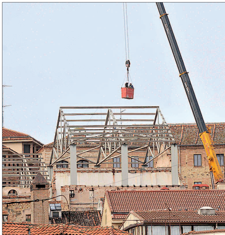
El Teatro Cervantes mantiene el solar vacío, tras la eliminación de las cerchas. / EA
