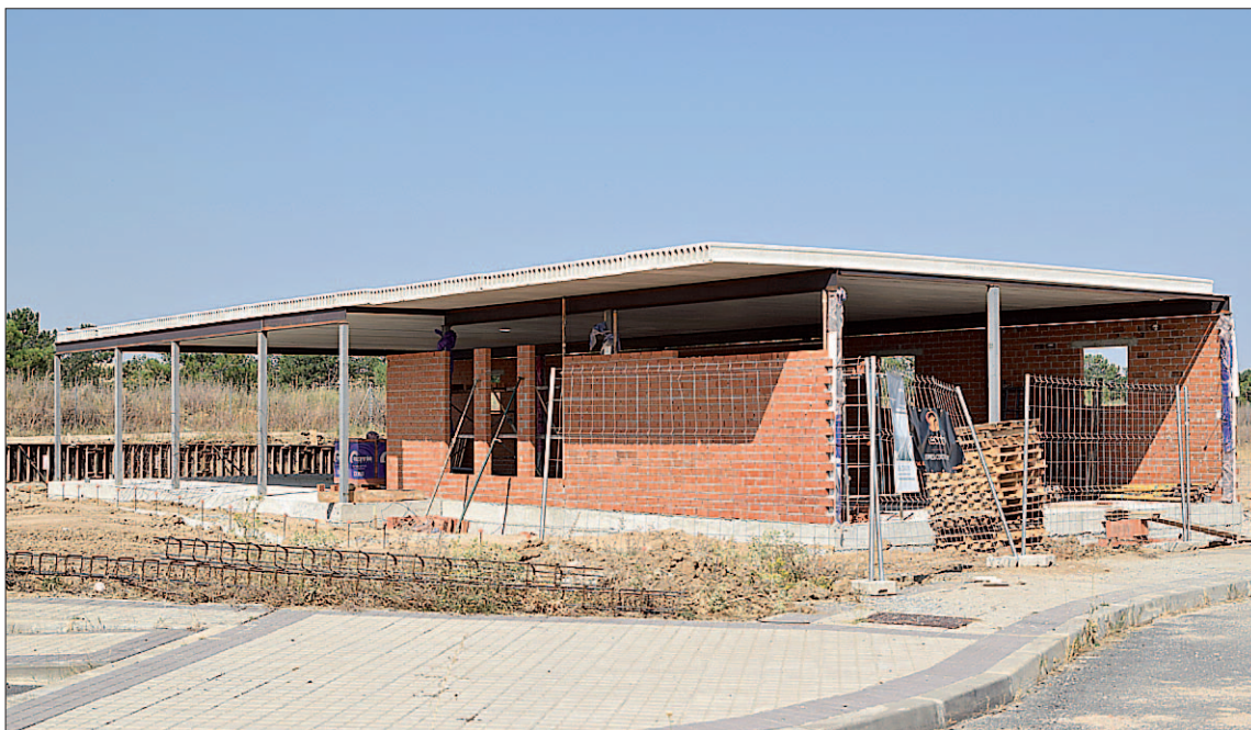
Estado actual en el que se encuentra la construcción del futuro tanatorio. / ROCÍO PARDOS
