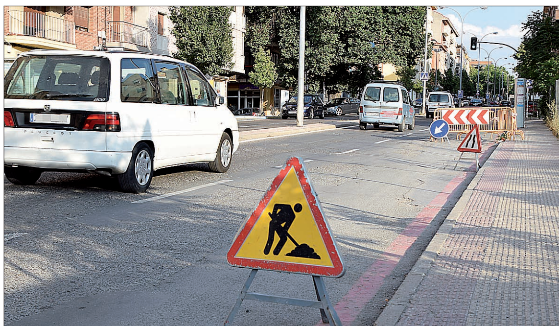
Las averías en las tuberías de la red municipal han sido habituales en el paseo de Ezequiel González. / ROCÍO PARDOS
