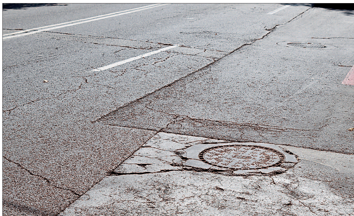
Detalle del estado del pavimento asfaltado en la avenida de Padre Claret. / ROCÍO PARDOS
