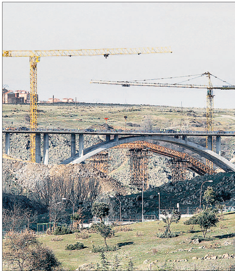
Imagen del desarrollo de las obras de desdoblamiento de la SG-20. /N. LLORENTE
