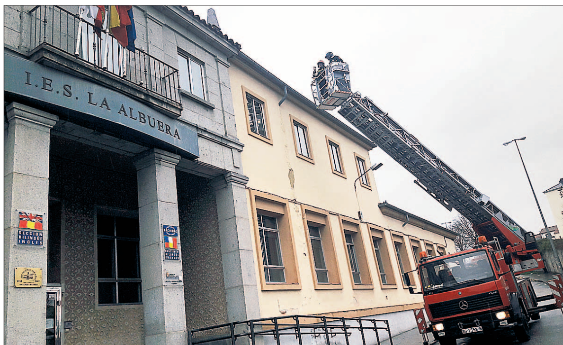
Intervención de los bomberos en el instituto La Albuera, donde había riesgo de desprendimiento de tejas. / EL ADELANTADO
