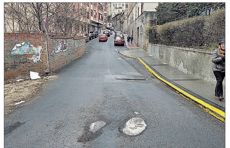
Los baches son apreciables en la calle Antonio Machado que ha sido objeto del plan de asfaltado y renovación de redes en los dos últimos años. / EL ADELANTADO
