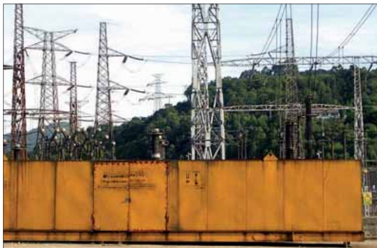
Subestación de la central térmica de Lada. / EUROPA PRESS
