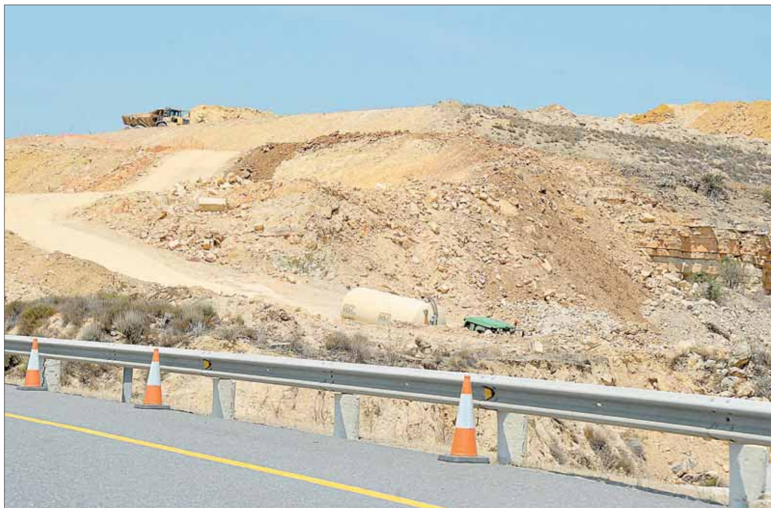
El movimiento de tierras que es necesario para llevar a cabo la obra se realiza bajo estrictas medidas de seguridad. / KAMARERO
