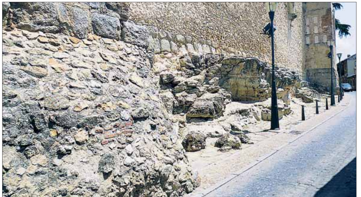
Los trabajos permiten apreciar con mayor detalle la roca sobre la que se asienta la Muralla en este acceso al Salón. / E. A.
