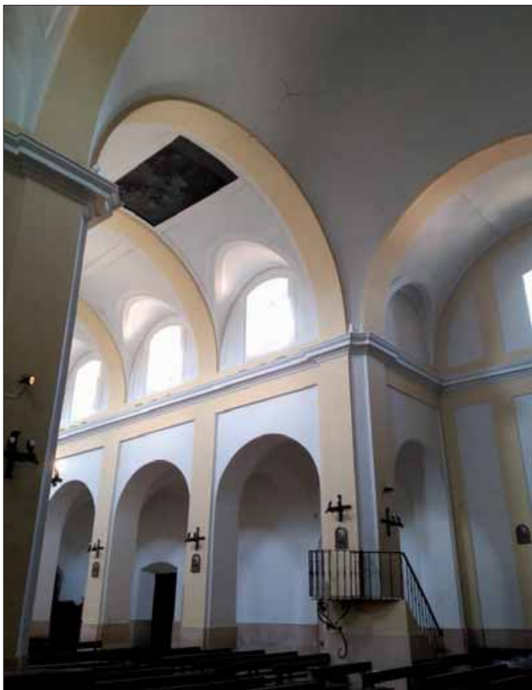
Figura 5: Detalle de la bóveda del crucero, nave mayor y naves laterales de la iglesia.
