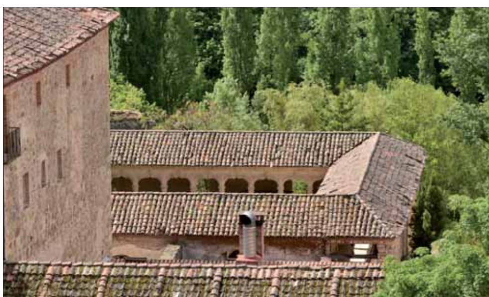
Estado actual de las cubiertas en el monasterio del Parral, se puede apreciar el mal estado de la teja, colocada a canal y cobija, frente a la cobertura con teja a la segoviana.
