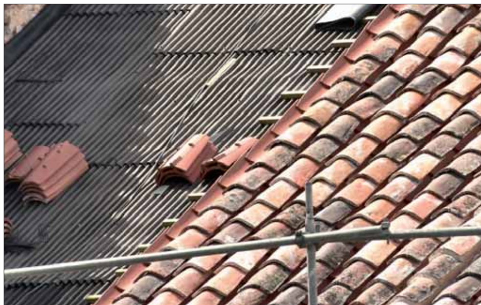
Extraña solución constructiva que utiliza rastreles sobre la placa de fibroasfalto, para colocar una teja a canal aplantillada con machos y sobre ellas con teja vieja a cobija se finaliza la cobertura.
