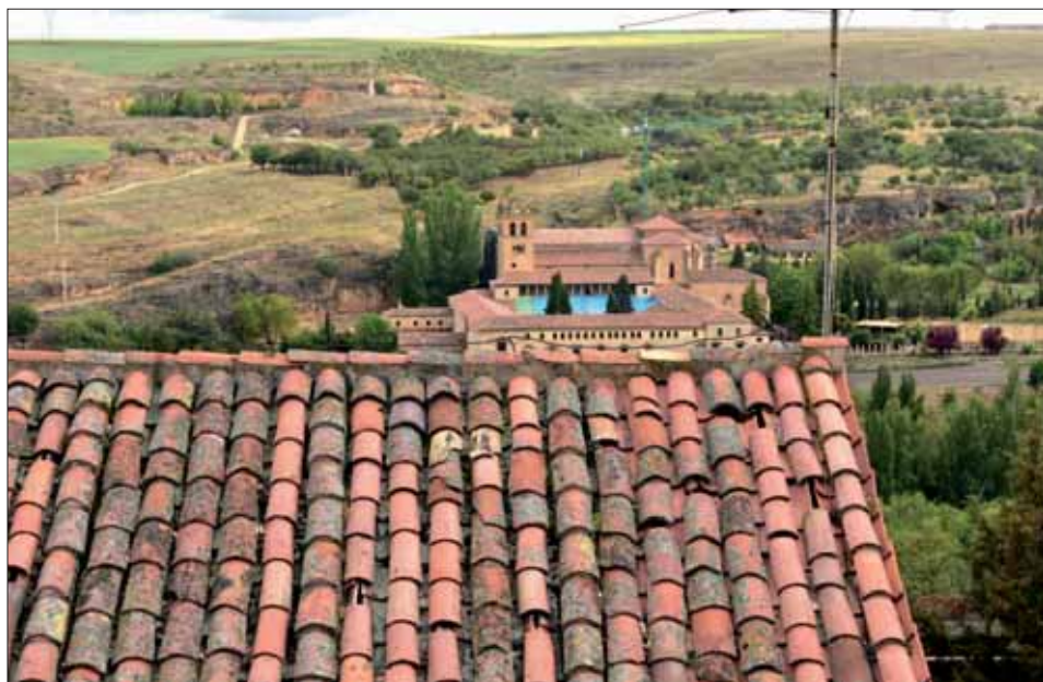
En esta fotografía se aprecia lo que ocurre cuando se coloca una cobertura de teja cerámica curva a canal y cobija, los pájaros buscan resguardo bajo las tejas y las mueven.
