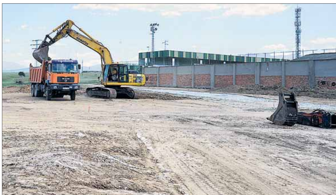
Ya ha comenzado el movimiento de tierras para acondicionar la parcela municipal que acogerá el ferial. / KAMARERO
