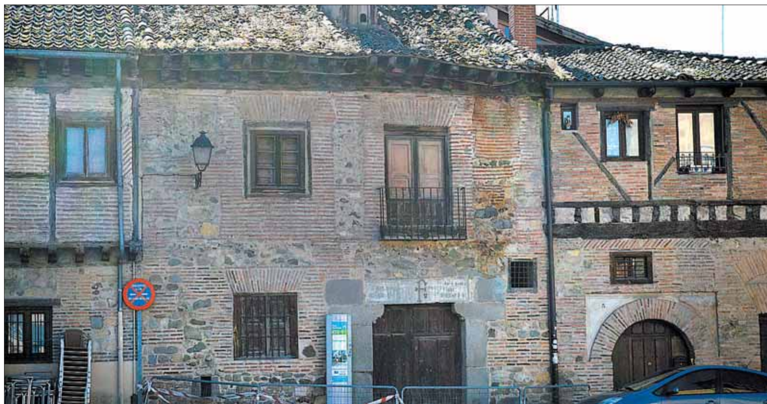
La cubierta de este edificio de la plaza de San Lorenzo está en mal estado, lo que ha motivado la caída de cascotes a la vía pública. / TAMARA DE SANTOS
