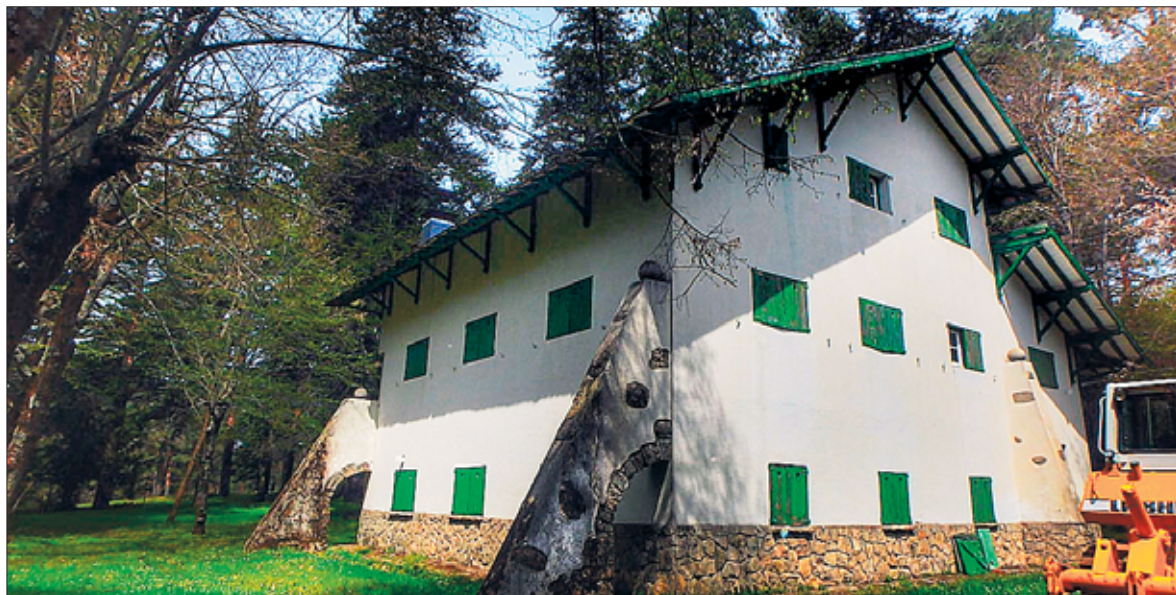
Estado actual de la 'Casa de La Campanilla', en el monte 'Dehesa de la Garganta'. / EL ADELANTADO
