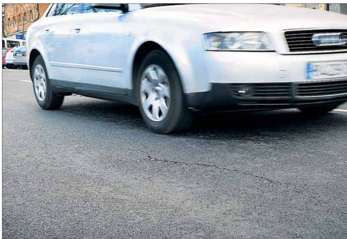
Una grieta muestra como está cediendo el asfalto en este tramo de la avenida de la Constitución. / KAMARERO
