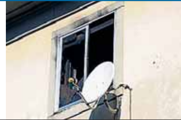
Ventana de la vivienda en la calle Londres afectada por las llamas.
