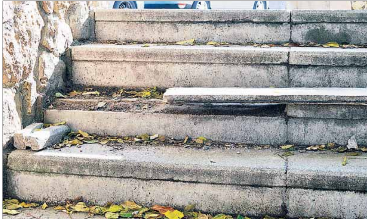
Estado de algunos peldaños de estas escaleras en uno de los accesos al grupo de viviendas el pasado octubre. / T. DE SANTOS
