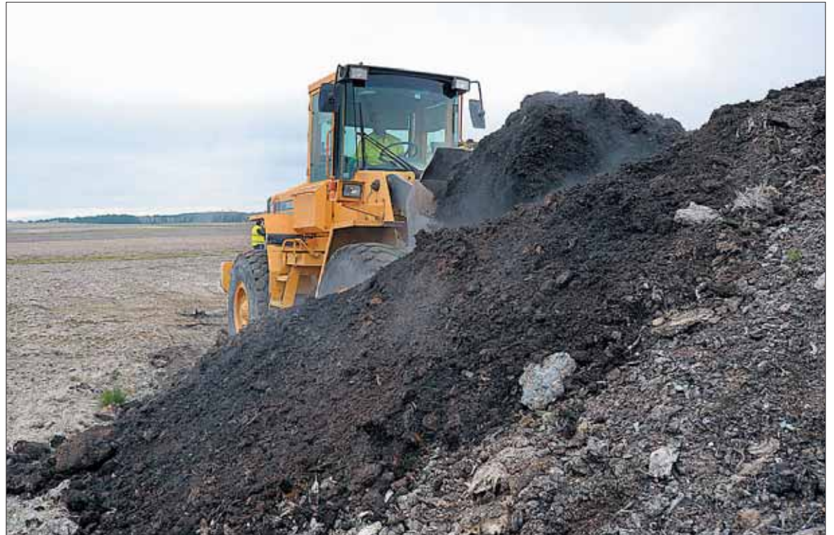
Imagen de la retirada de los residuos amontonados en tierras de labor por la propiedad de la planta de compostaje. / E. A.
