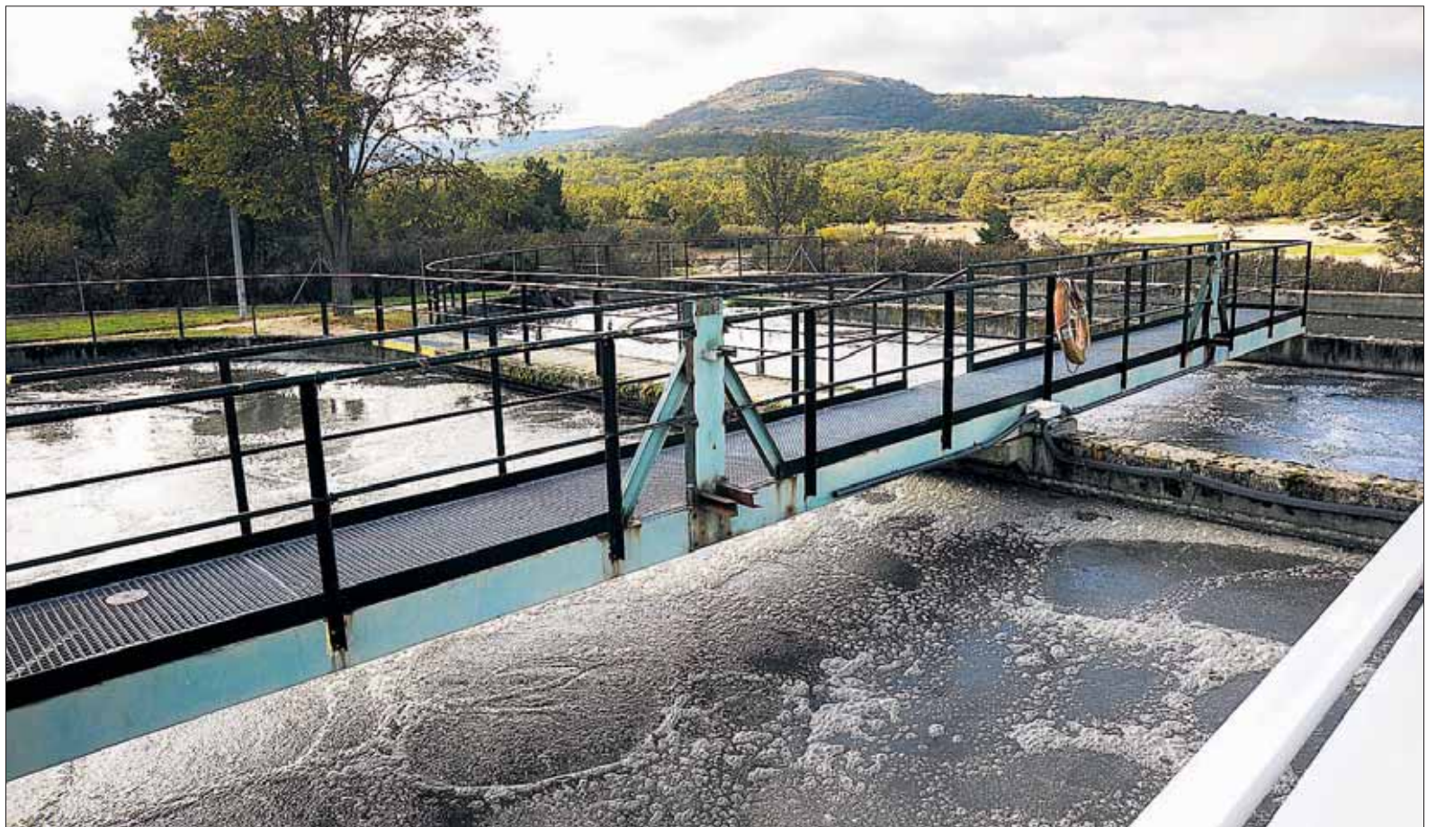
La remodelación de las instalaciones de la EDAR del Real Sitio ha requerido de una inversión de 2,1 millones de euros. / KAMARERO
