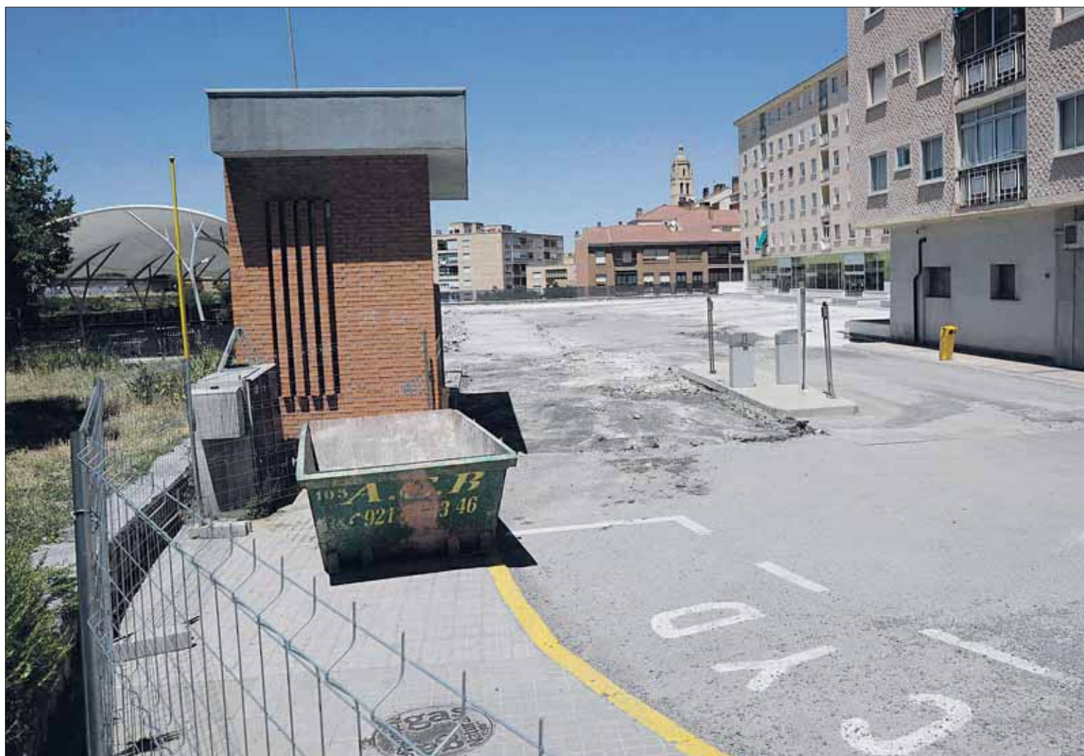
Las obras en la campa de la estación de autobuses enmascaran la reciente sentencia que obliga a impermeabilizar y acondicionar los sótanos del edificio contiguo. / K.
