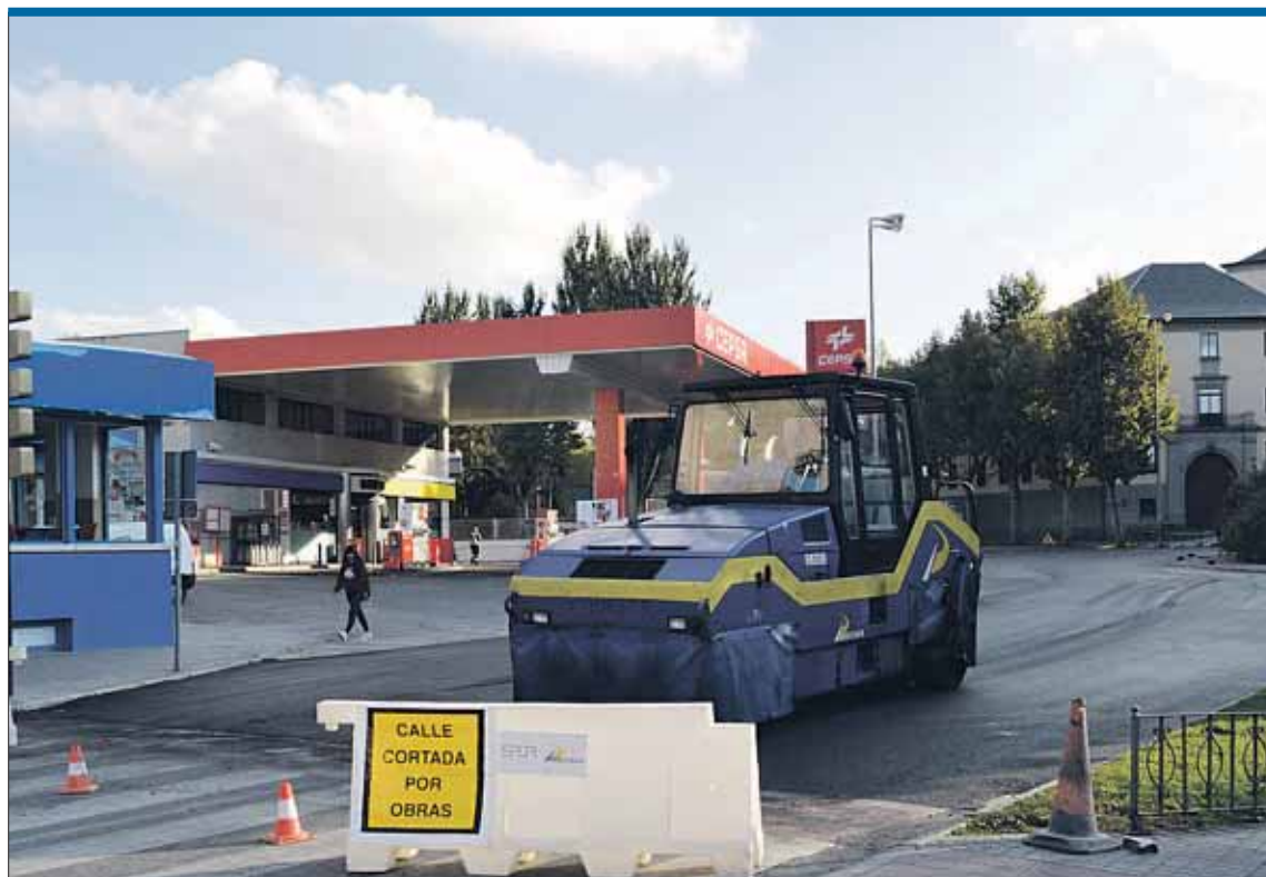
Corte de tráfico en la rotonda de La Pista. La rotonda de La Pista estuvo cortada ayer al tráfico desde las tres hasta las siete y media de la tarde para proceder a su asfaltado. También se impidió el tráfico en ambas direcciones por la avenida Juan Carlos I y la avenida de la Constitución. Las líneas de autobuses 7,8 y 4, como muchos conductores particulares modificaron sus itinerarios. / FOTO: TAMARA DE SANTOS
