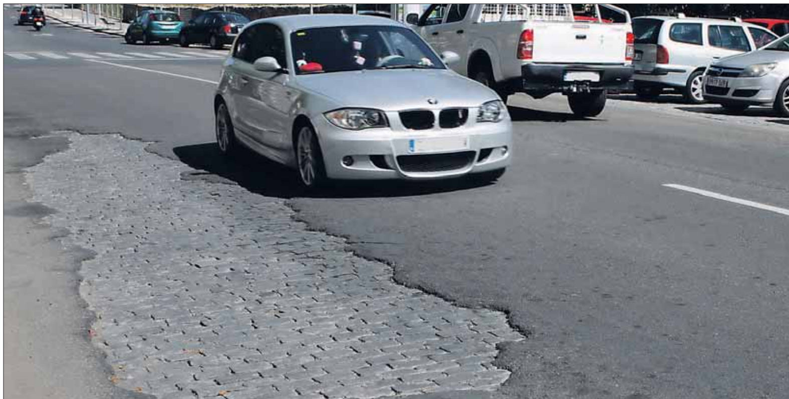
Los baches de la calle Obispo Quesada están dejando al descubierto los adoquines que aún se mantienen bajo el asfalto. / EL ADELANTADO
