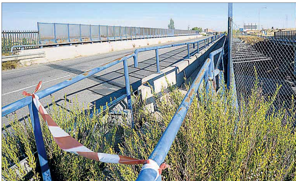
El paso por el puente ha sido cortado al tráfico para evitar problemas. / KAMARERO
