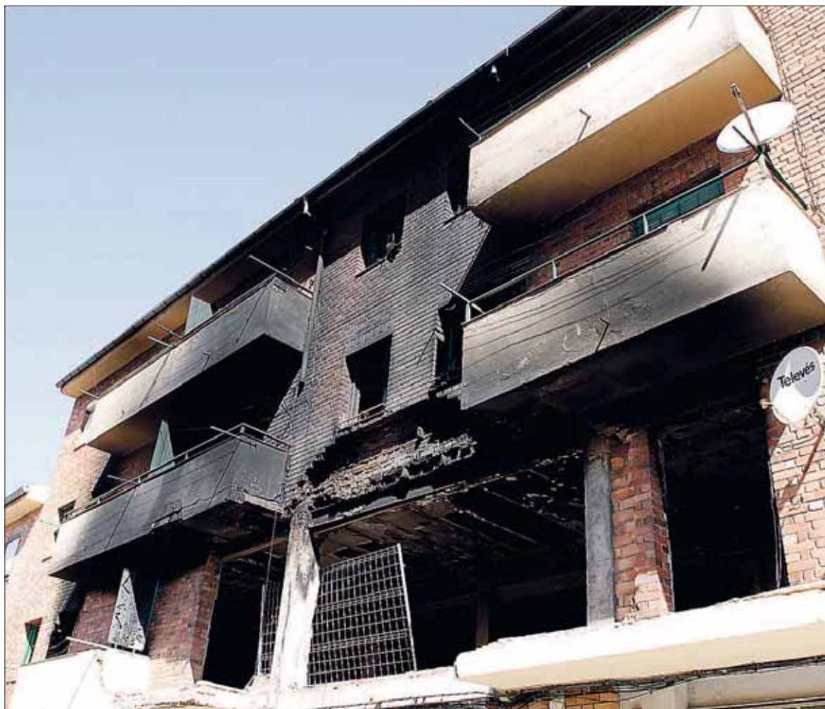
La fachada principal del edificio del número 5 de la Calle Coca, la mañana del día siguiente al del incendio. / NEREA LLORENTE
