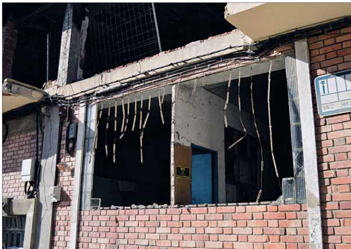
Las viviendas de las familias afectadas sufrieron importantes daños. / CRISTINA YUSTA
