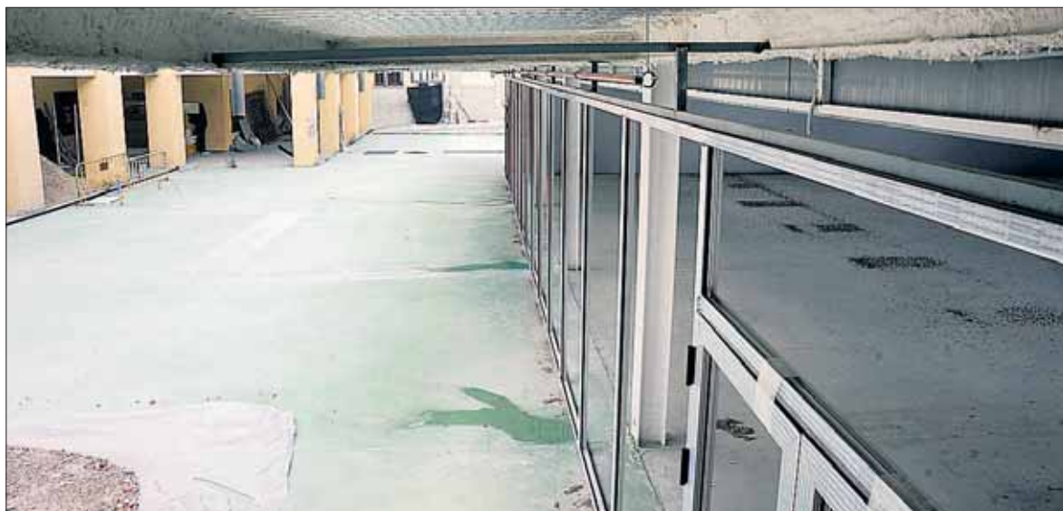
La estructura incompleta del pabellón deportivo invade e inutiliza el patio de recreo del colegio El Peñascal. / KAMARERO
