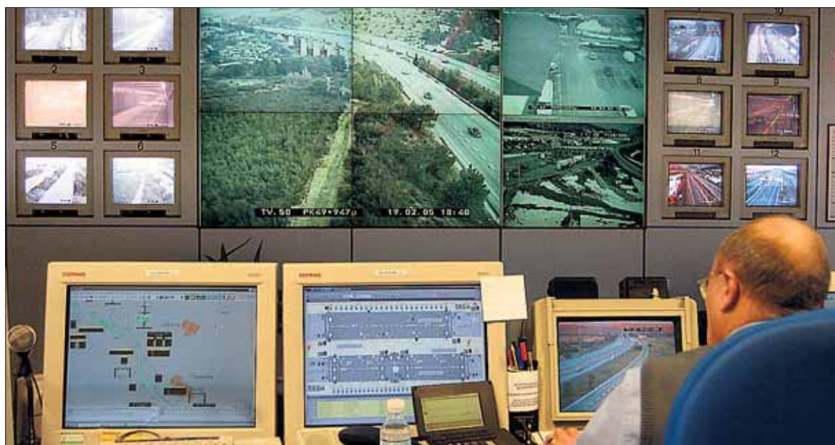
Un trabajador controla las carreteras a través de las pantallas del Centro de Control de San Rafael. / KAMARERO
