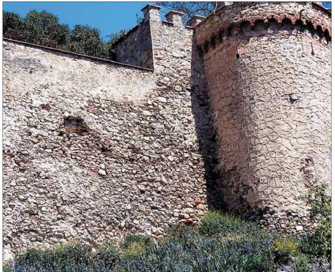
El cubo 16 de la Muralla, en la calle San Millán, se encuentra deteriorado, lo que justifica las obras de emergencia. / E. A.
