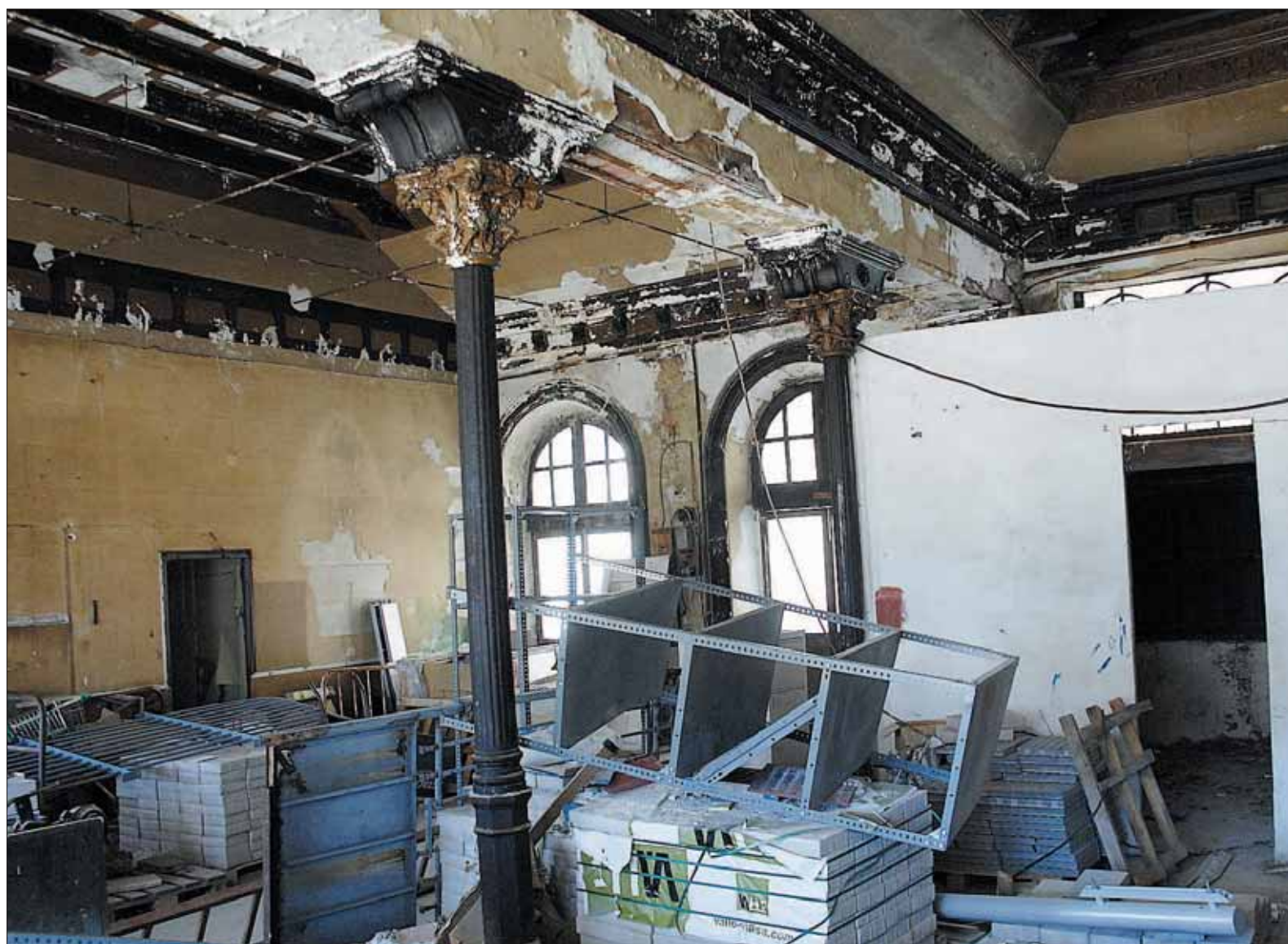
Estado de abandono de una de las salas de la estación de ferrocarril inaugurada en 1884. / JUAN MARTÍN Arriba, dibujo de la fachada principal en el proyecto original.
