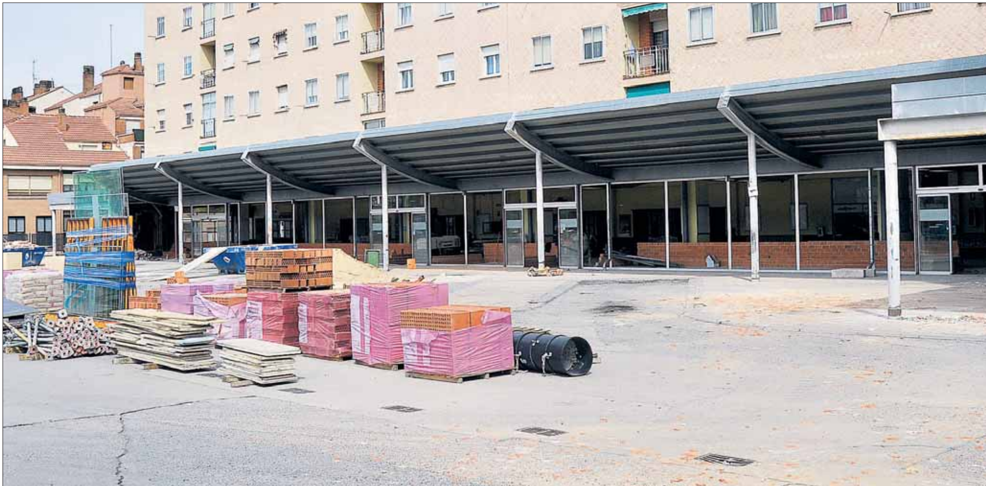
La campa de la estación de autobuses presentaba ayer esta imagen, con la marquesina a retirar adosada al edificio. El inicio del periodo de ejecución de las obras fue el pasado día 7. / KAMARERO
