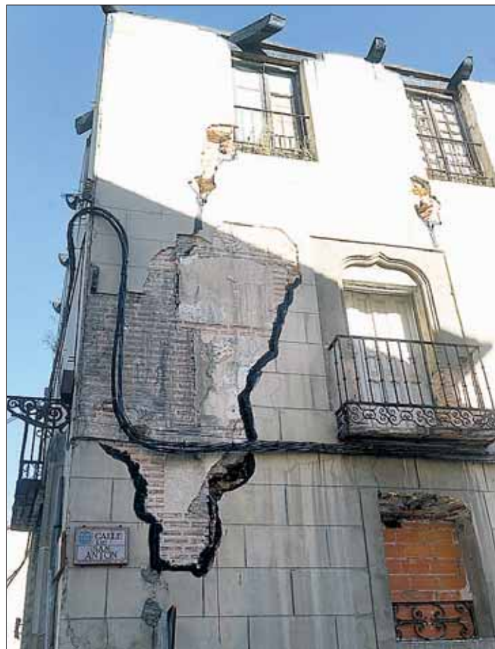
Grieta que presenta el edificio en la fachada a San Antón. / KAMARERO
