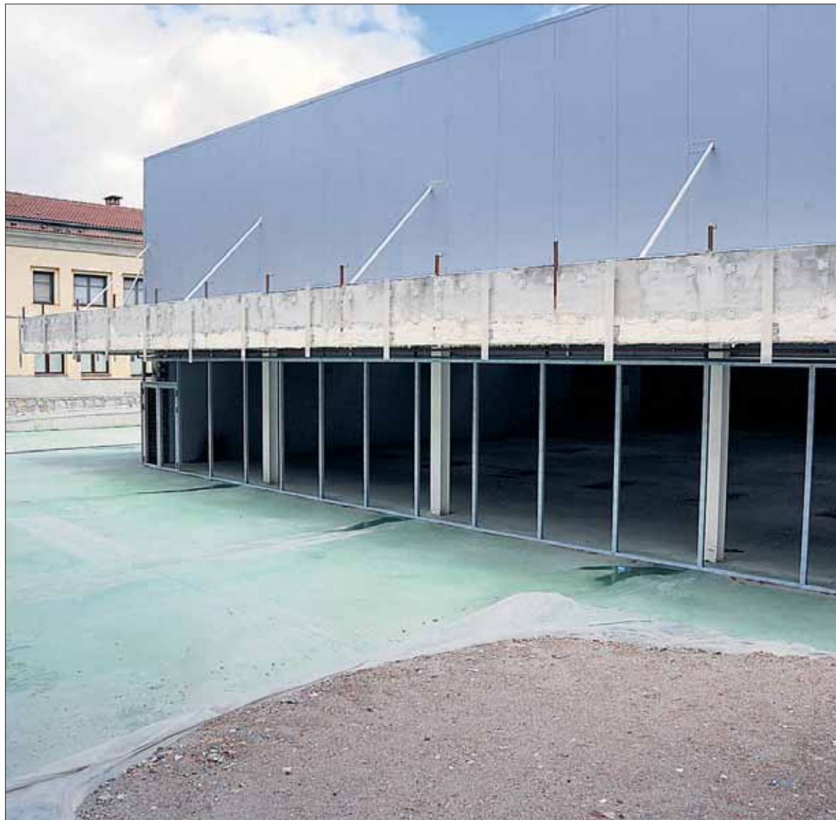
Las obras del gimnasio del CEIP El Peñascal permanecen paralizadas desde hace varios meses. / KAMARERO
