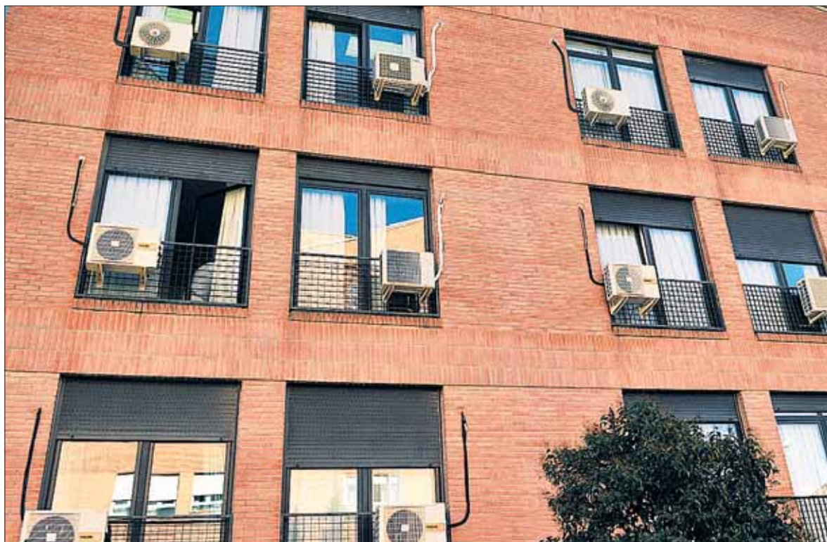
Un bloque de viviendas nuevas con sistemas de refrigeración o aire acondicionado. / KAMARERO
