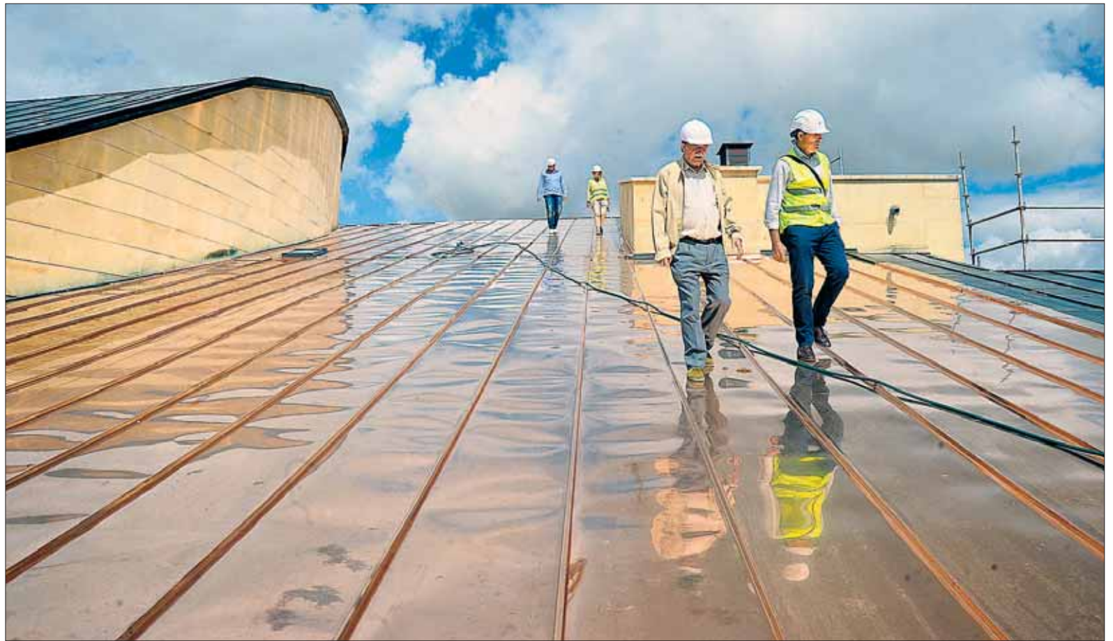
El equipo técnico mientras realizaba el simulacro hídrico sobre la cubierta de cobre del Conservatorio de Música. / KAMARERO
