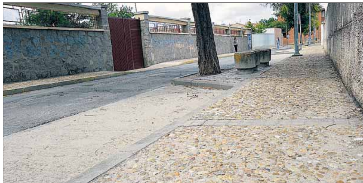
Una de las actuaciones previstas consiste en reparar las aceras de la calle Ávila, en la zona de El Carmen. / KAMARERO
