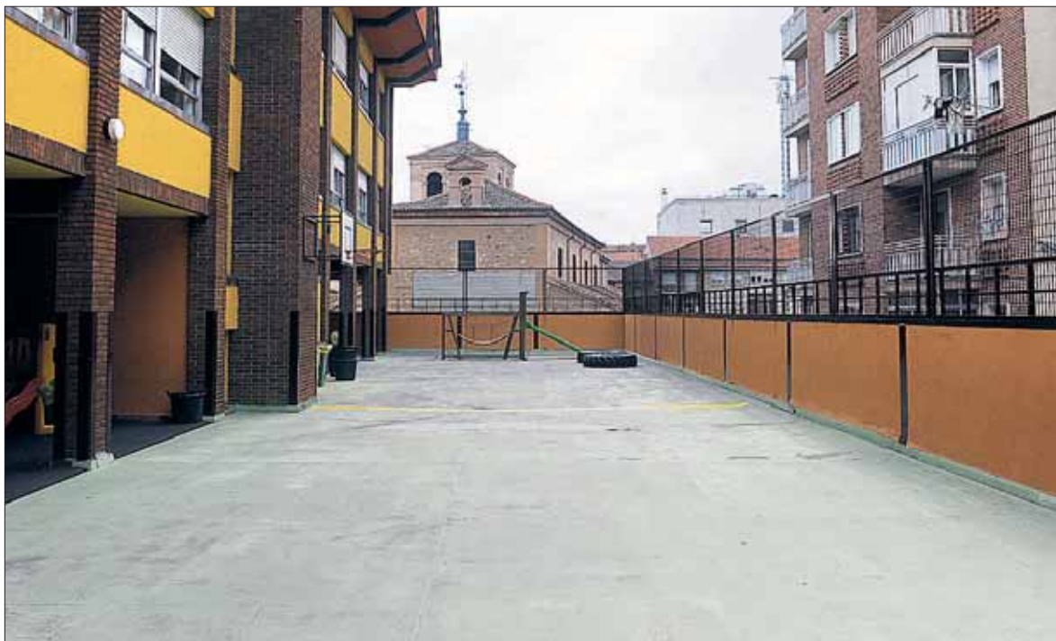
Las grietas del patio, en la imagen, han motivado filtraciones y daños en otras instalaciones del centro. / KAMARERO
