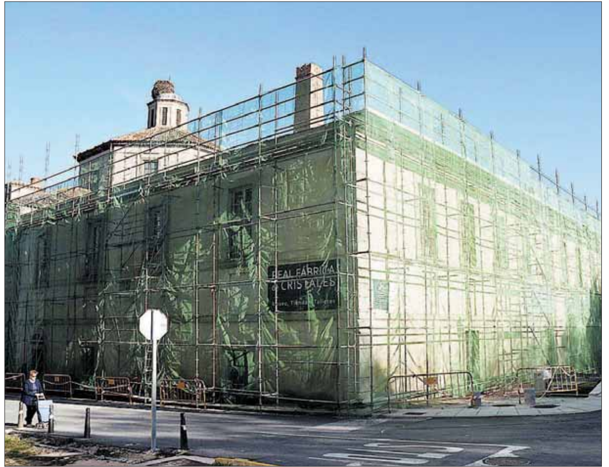
Durante el año pasado se acometieron las obras de rehabilitación de las cubiertas del edificio. / JUAN MARTÍN
