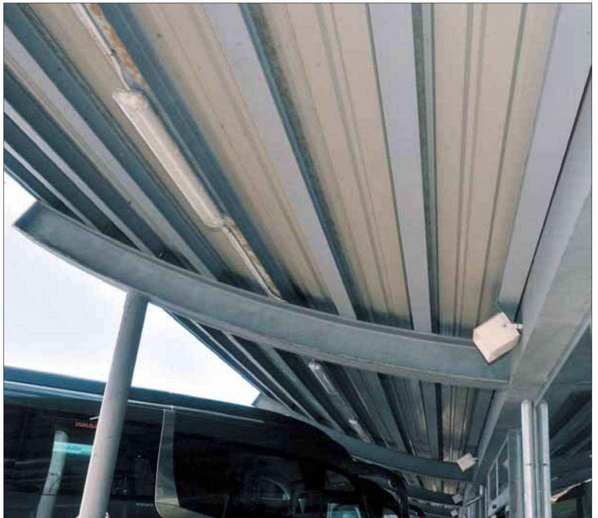
La marquesina anclada al edificio de viviendas será derribada por el Ayuntamiento "cuanto antes". / KAMARERO
