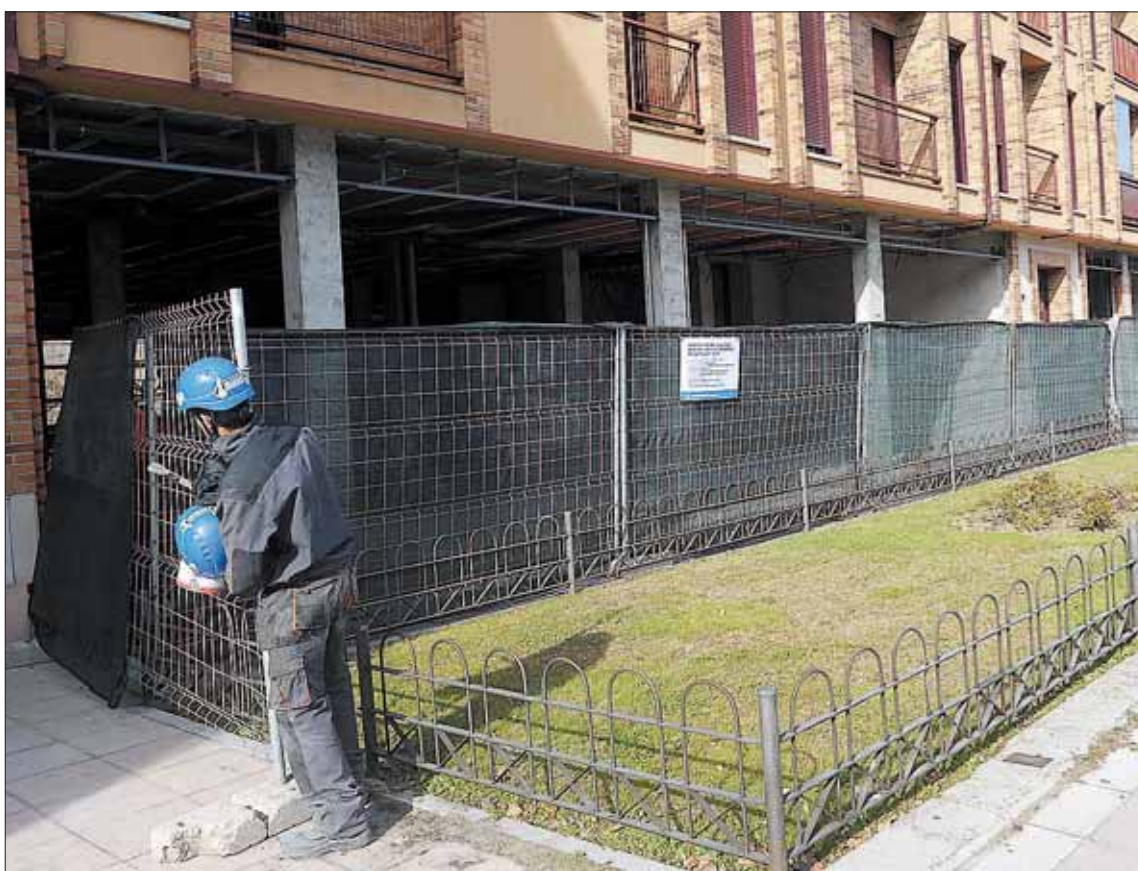
Imagen del inicio de las obras en el local de Vía Roma, el pasado mes de noviembre. / KAMARERO
