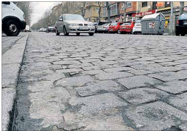
Estado de la calzada de la avenida de la Constitución. / KAMARERO
