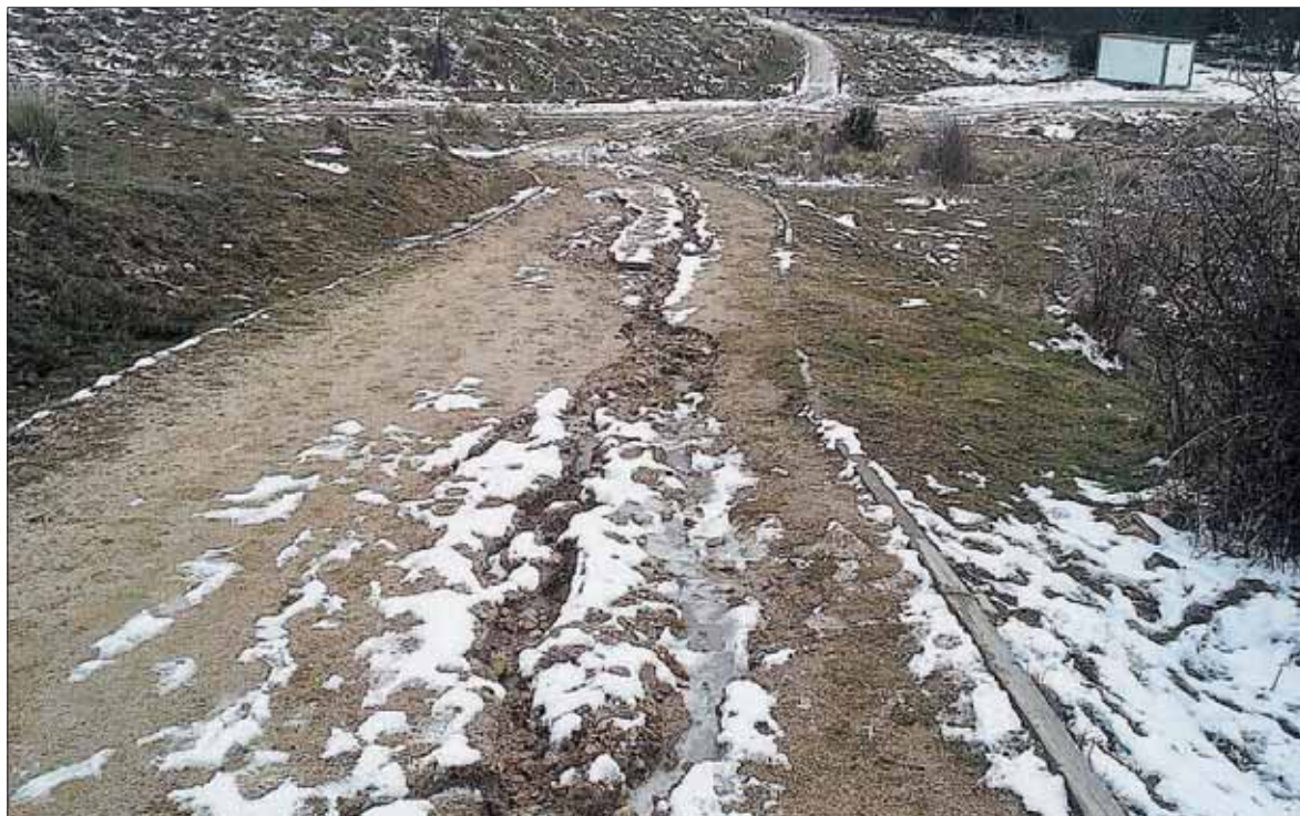
La Senda Verde se ha visto afectado por las últimas lluvias y nieves del invierno. / EL ADELANTADO
