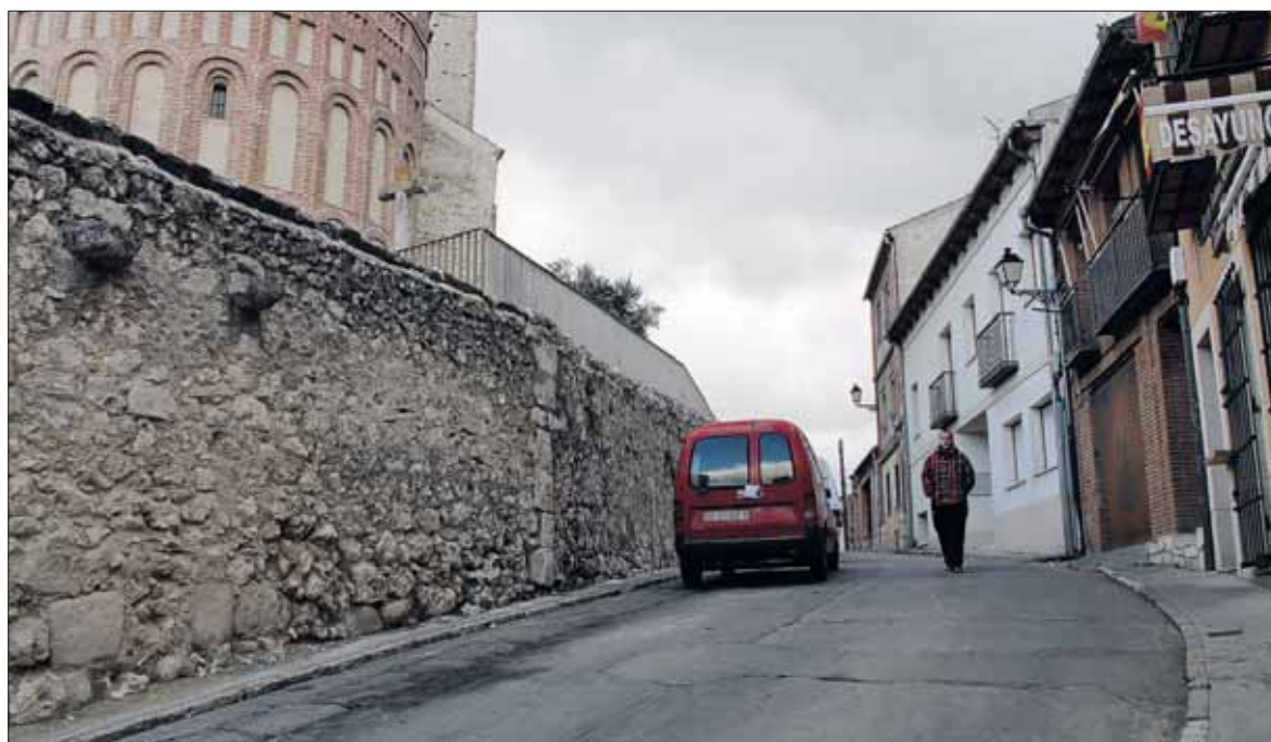
La calle San Esteban también será adoquinada para acabar con los problemas de filtraciones y humedades./ CHANTAL NÚÑEZ
