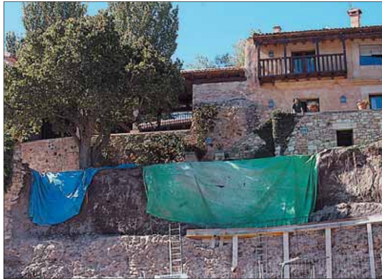
Otro derrumbe en la muralla de Pedraza, acaecido en 2007. / GUILLERMO HERRERO
