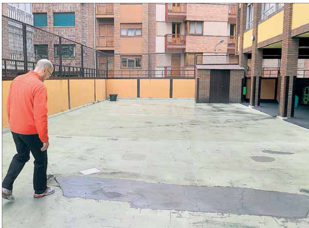
El patio destinado a los alumnos de Infantil tiene grietas y parches que provocan tropezones y caídas. / KAMARERO
