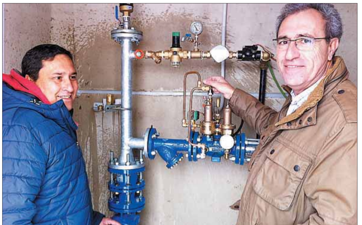
El alcalde de Sotosalbos (derecha) abre el enganche que conecta el depósito con la presa del Ceguilla. / EL ADELANTADO
