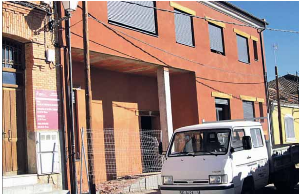
El edificio multiusos, donde se ubicará el futuro consultorio médico, se sitúa junto al Ayuntamiento. / ALVARO PINELA
