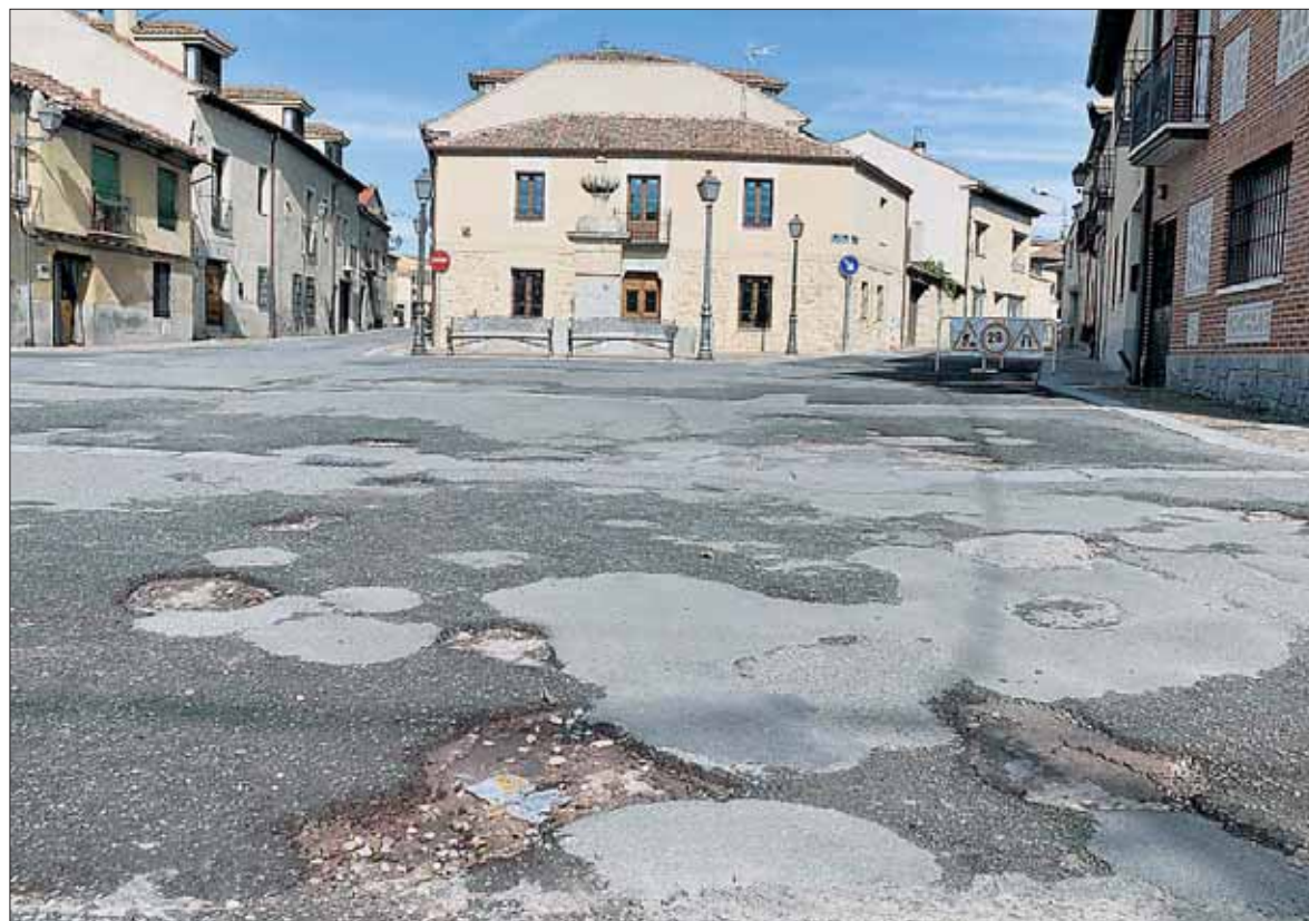
Estado actual de la Plaza de las Alcaldesas. El firme presenta un estado lamentable. / JUAN MARTÍN
