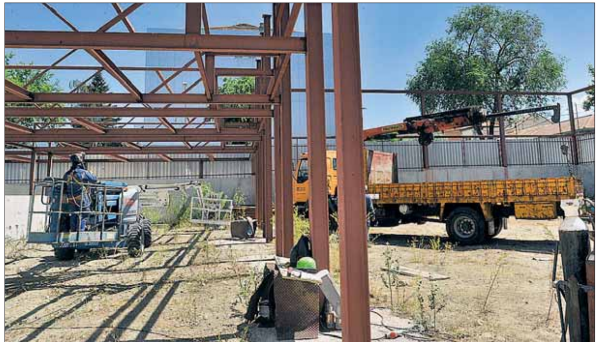
El desarrollo de obras, que empiezan y se paran, en el patio escolar puede haber provocado la presencia de ratas. / KAMARERO
