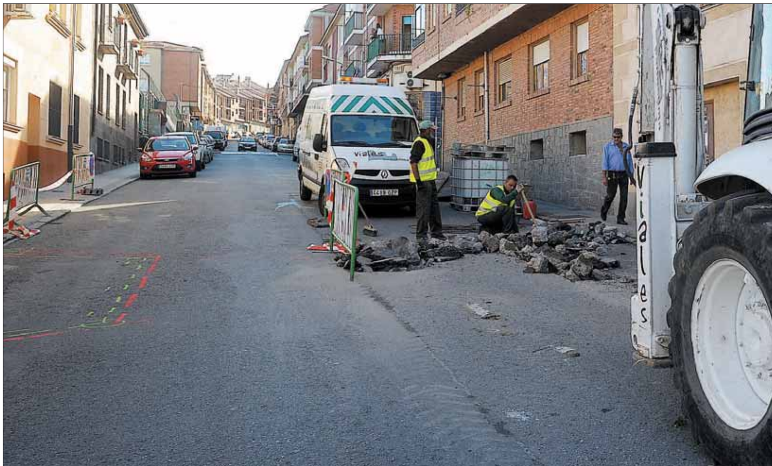
Hace aproximadamente una semana comenzaron los trabajos de construcción de dos pasos de peatones elevados en la calle de Las Nieves. / KAMARERO
