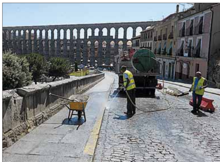
Operarios trabajando en la calle San Juan en los primeros días de agosto./ KAMARERO
